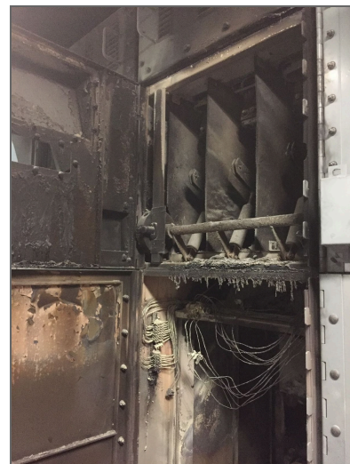
(d) Switchgear failure and fire
